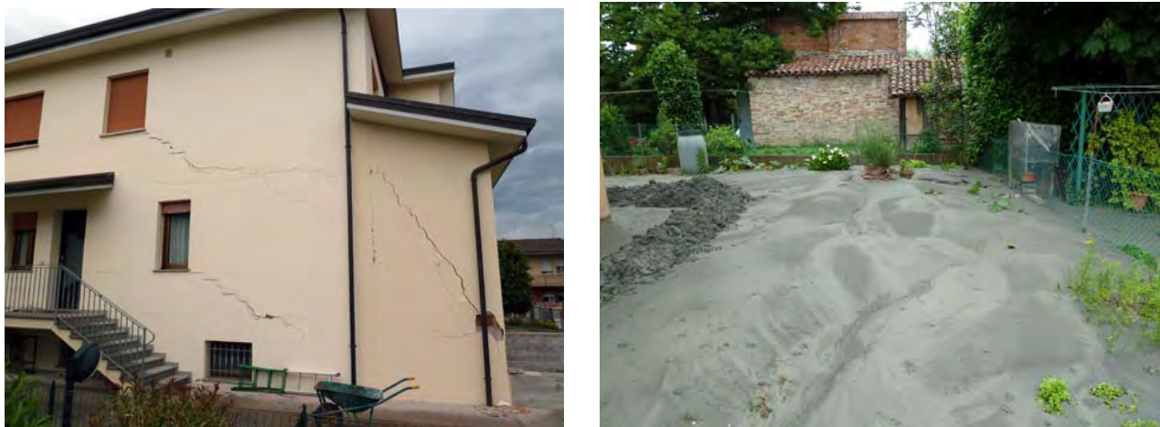
Fig. 9 – San Carlo. Cedimento differenziale di un edificio misto in c.a. e muratura per liquefazione con sviluppo di lesioni di livello 3. A destra, poco lontano, evidenze di liquefazione di sabbie eiettate da un pozzetto.
