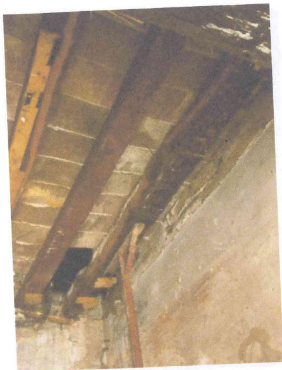
Foto n. 10 crollo parte del solaio del magazzino e inflessione delle travi con distacco da muratura
