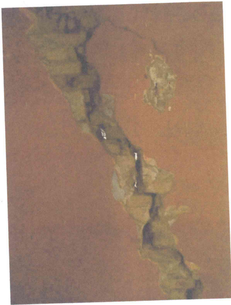
Foto n. 15 Particolare della crepa passante con dimensioni superiori a mm. 10
