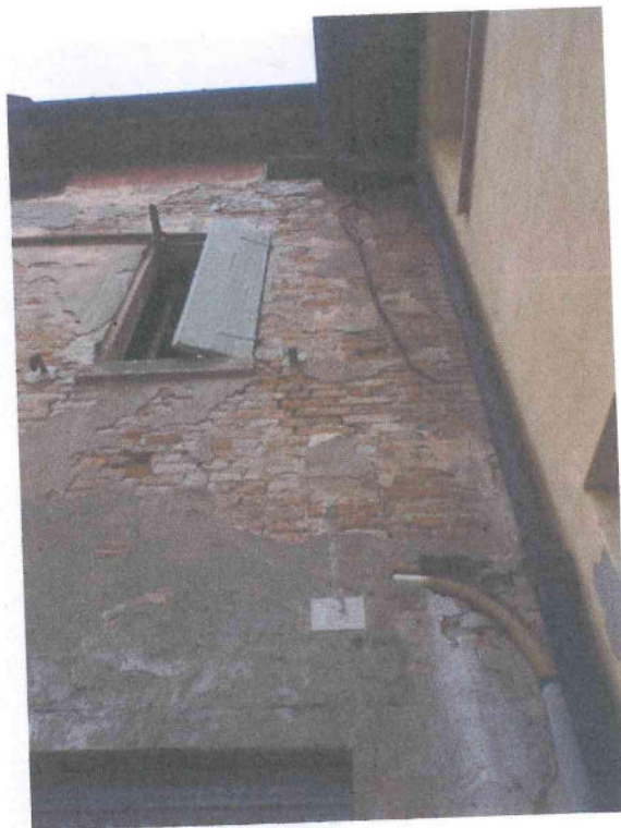
Foto n. 3 Particolare delle crepe
