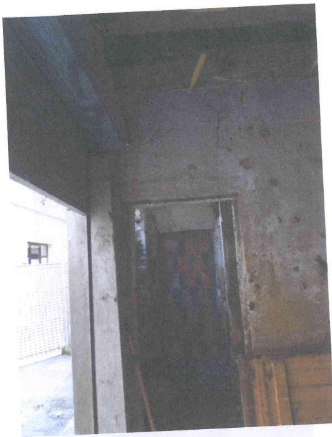
Foto n. 8 Distacchi della fascia di muratura in corrispondenza dell'architrave in mattoni che soggetto a flessione, indotta dal sisma, si è rotto nella zona delle fibre tese e sconnessione delle murature
