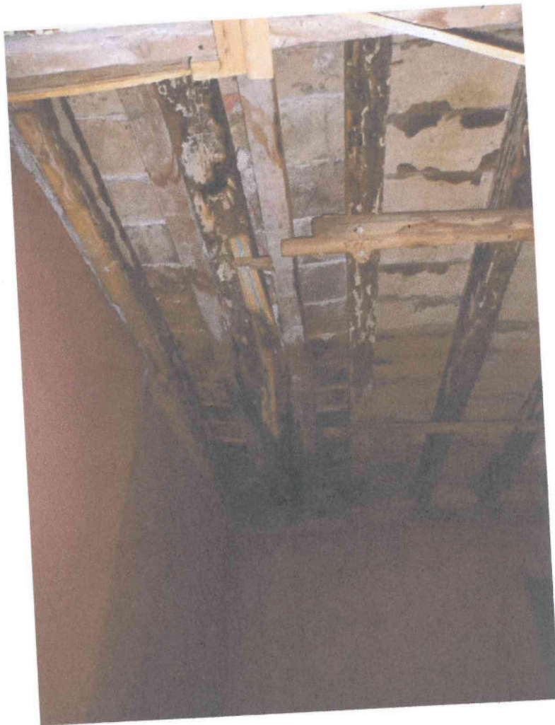
Foto n. 16 Particolare dei solaio inflessi e fatiscenti
