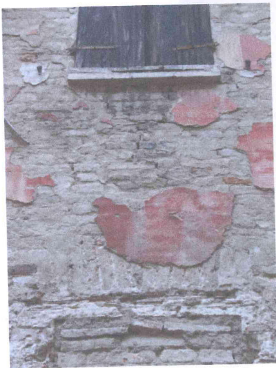
Foto n. 6 Particolare delle crepe a 45°
