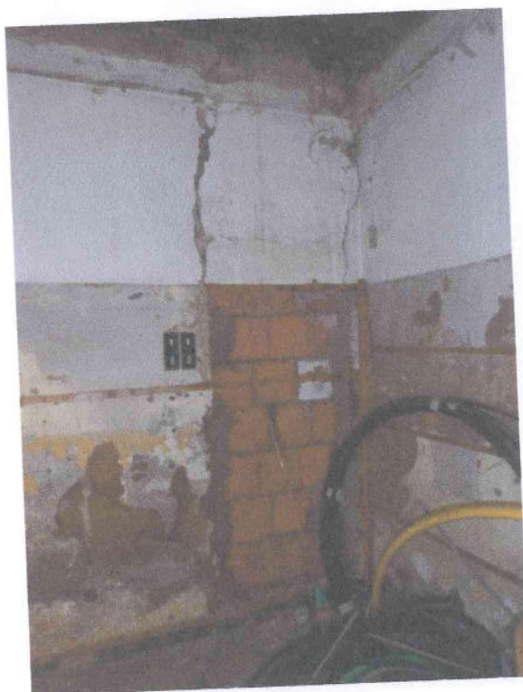
Foto n. 11 Distacchi della fascia di muratura in corrispondenza dell'architrave in mattoni che soggetto a flessione, indotta dal sisma, si è rotto nella zona delle fibre tese e sconnessione delle murature
