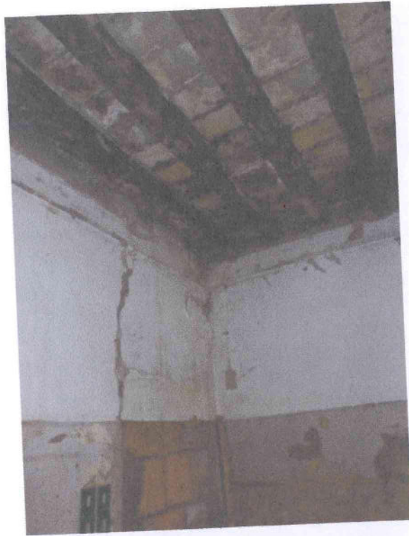
Foto n. 12 Vista solaio in legno ordito senza trave principale con elevata inflessione di piano
