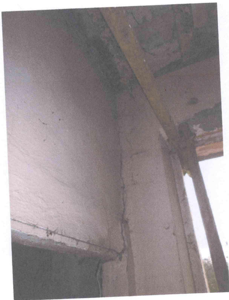
Foto n. 17 Distacchi della fascia di muratura in corrispondenza dell'architrave in mattoni che soggetto a flessione, indotta dal sisma, si è rotto nella zona delle fibre tese e sconnesione delle murature con cinematismo verso l'etmo della parete portante
