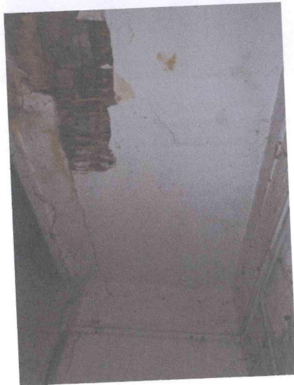
Foto n. 13 Rottura trave reggi scala
