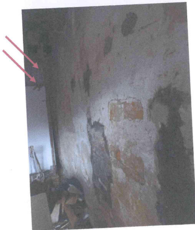
Foto n. 9 Pericoloso imbozzamento della parete in muratura a confine con altro fabbricato proprio a ridosso dell'appoggio della trave principale primo solaio
