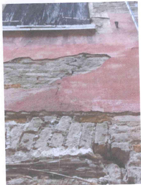
Foto n. 7 Particolare drepe e fessurazioni
