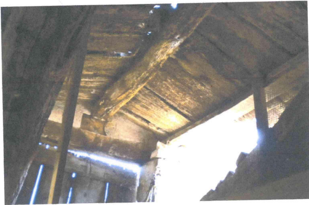
Foto n. 20 Vista dell'abbaino semicrollata e fatiscente
