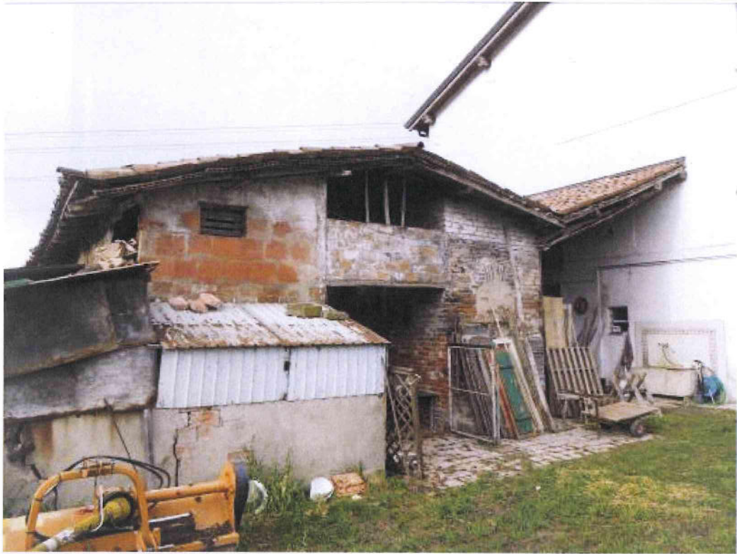
Cattiva tessitura muraria
