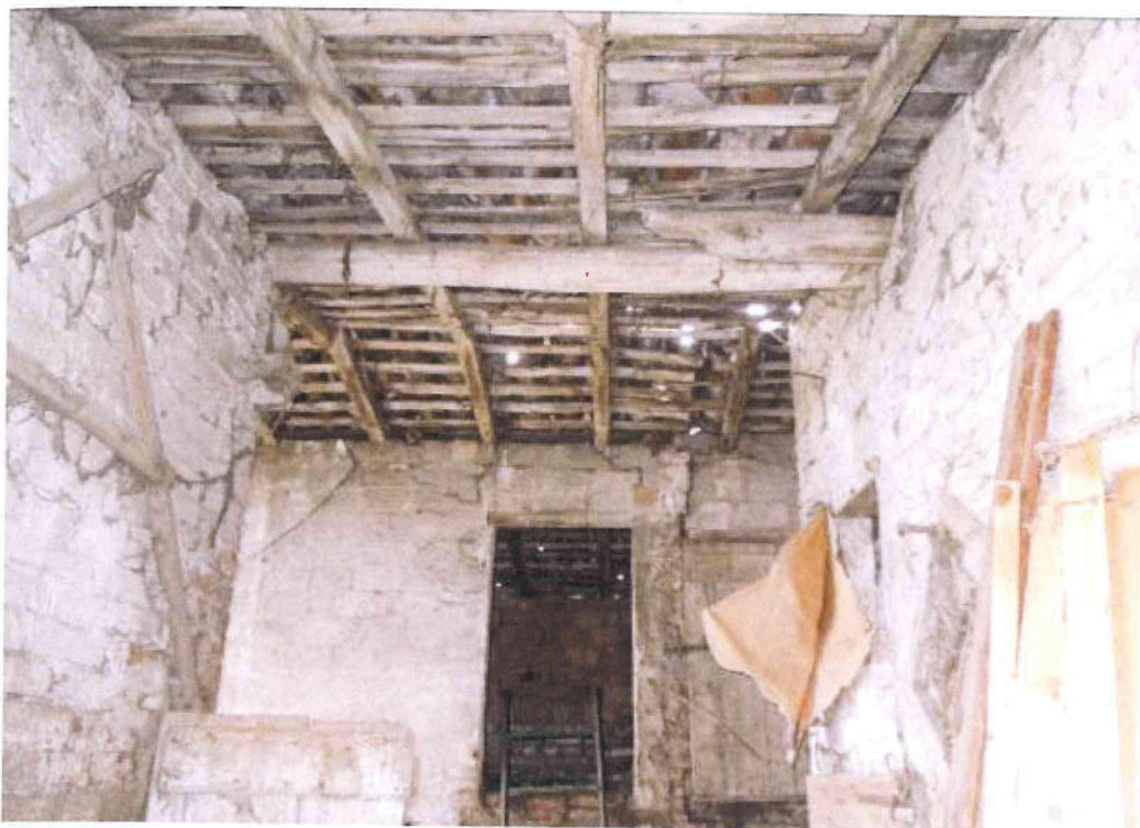
Mancanza di tavolato per la copertura che ha causato marcescenze e cedimenti di piano deformabile, presenza di umidità da infiltrazione atmosferiche
