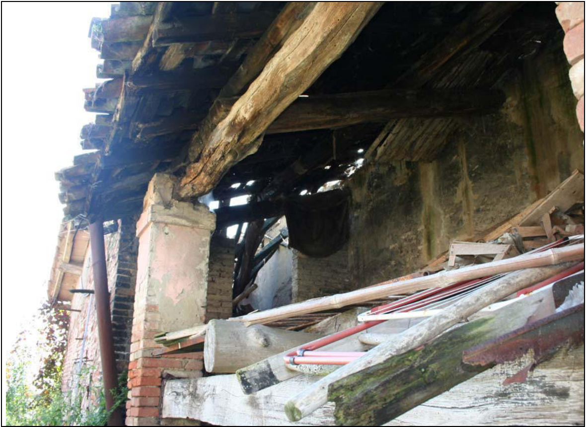
Foto n.6 particolare crollo copertura
