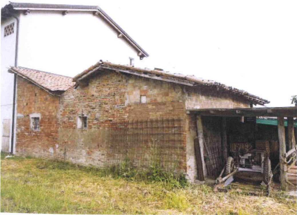
Cattiva tessitura muraria, lesioni passanti
