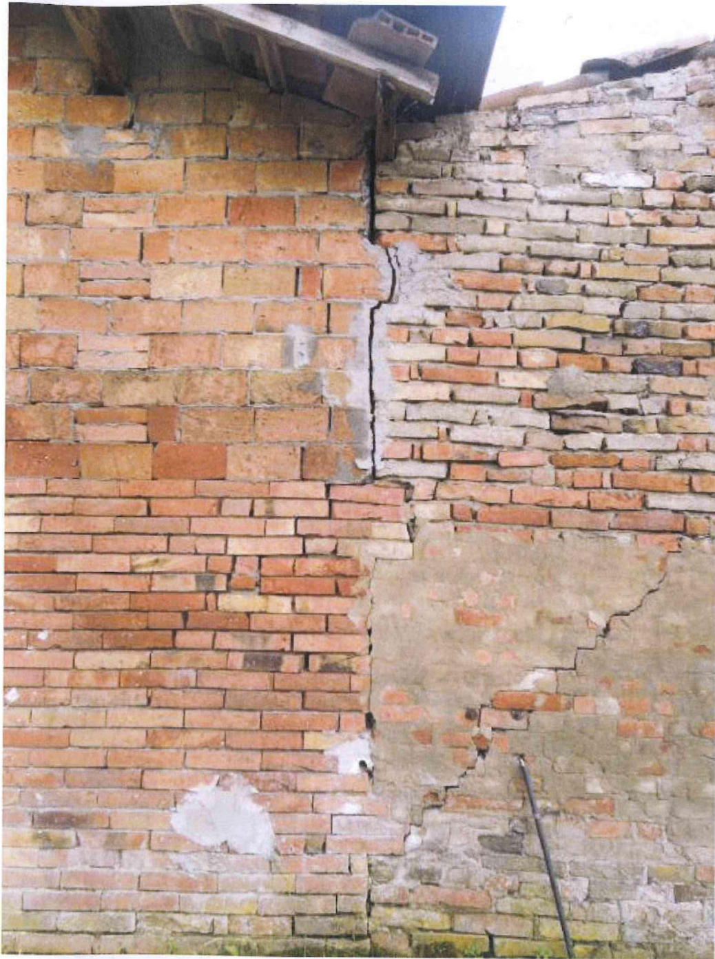
Cattiva tessitura muraria, lesioni passanti, mancanza di connessioni tra paramenti murari
