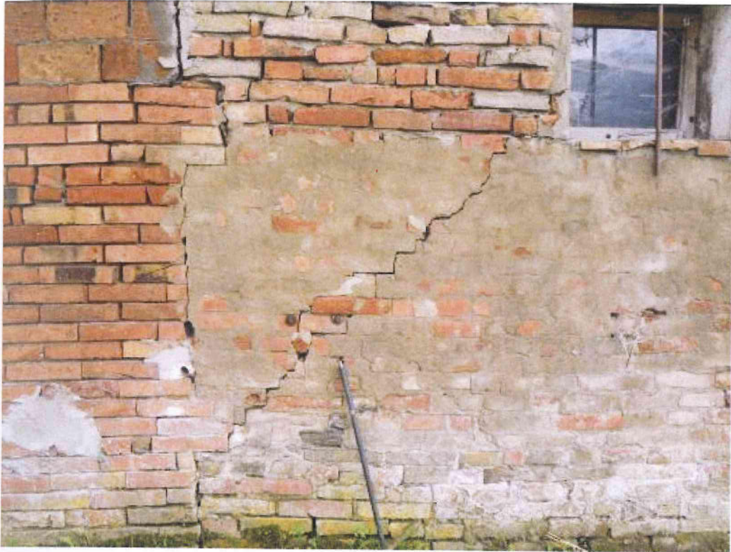
Cattiva tessitura muraria, lesioni passanti, mancanza di connessioni tra paramenti murari, umidità di risalita diffusa
