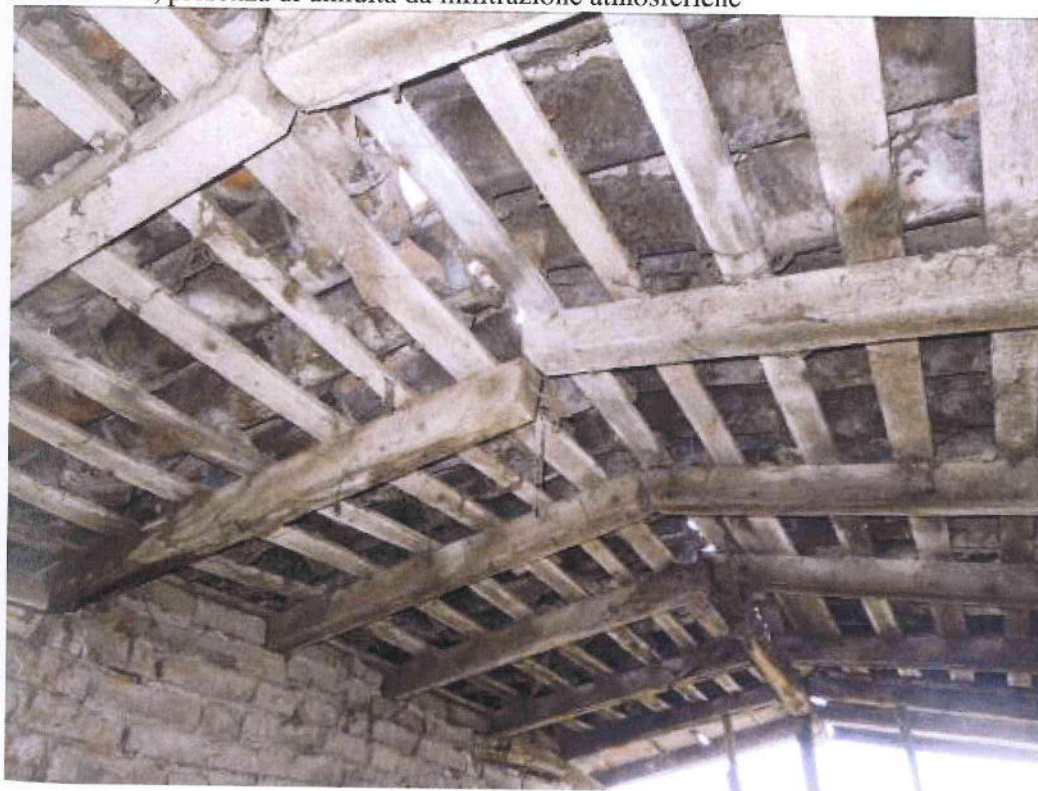
Mancanza di tavolato per la copertura che ha causato marcescenze e cedimenti di piano deformabile, presenza di umidità da infiltrazione atmosferiche, elementi in legno, sia nei solai che nel tetto, di dimensioni e stato conservativo fra i più svariati ed inaffidabili
