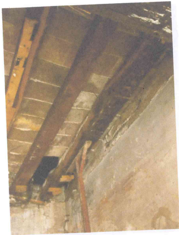
Foto n. 10 crollo parte del solaio del magazzino e inflessione delle travi con distacco da muratura
