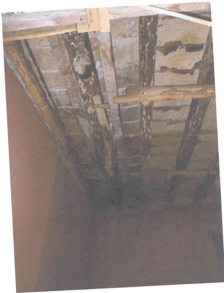
Foto n. 16 Particolare dei solaio inflessi e fatiscenti
