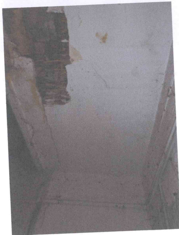
Foto n. 13 Rottura trave reggia scala
