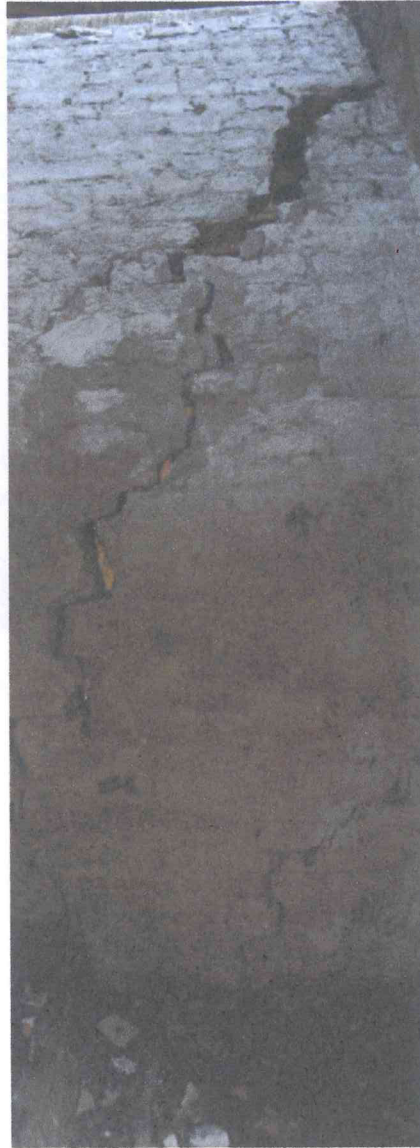
Foto n. 19 Formazione di fessurazioni o crepe passanti si evidenzia, una tipica rottura dei meccanismi di collasso nel piano della muratura, cioè quella inclinata, ovvero una lesione per taglio da trazione; questo criterio di rottura è da collegare al fatto che la porzione muraria in questione è estremamente tozza e quindi si ha la rottura con giacitura all'incirca di 45^\circ tra vano scala e camera
