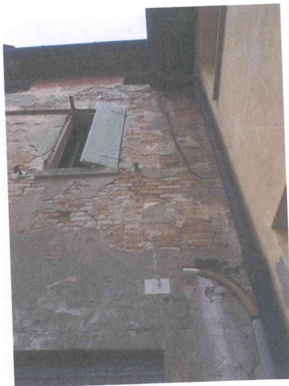
Foto n. 3 Particolare delle crepe
