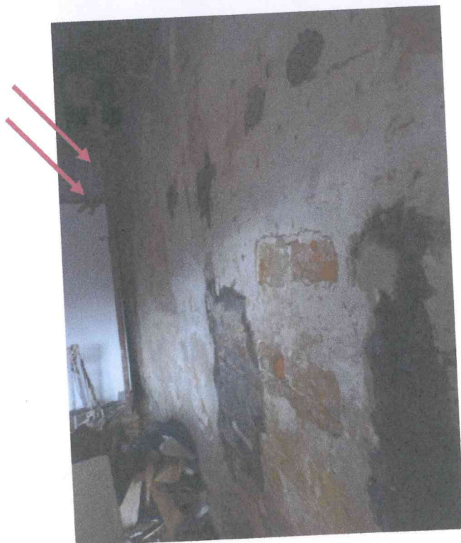
Foto n. 9 Pericoloso imbozzamento della parete in muratura a confine con altro fabbricato proprio a ridosso dell'appoggio della trave principale primo solaio
