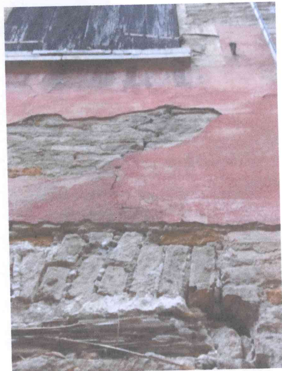
Foto n. 7 Particolare drepe e fessurazioni
