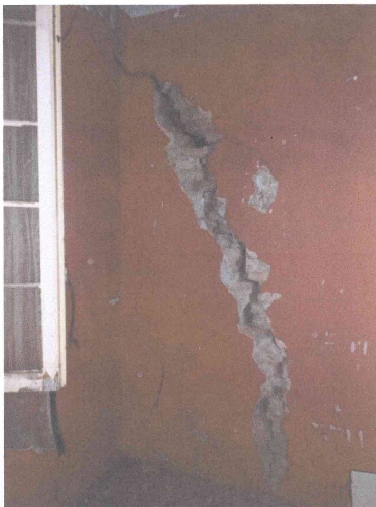
Foto n. 14 Formazione di fessurazioni o crepe passanti si evidenzia, una tipica rottura dei meccanismi di collasso nel piano della muratura, cioè quella inclinata, ovvero una lesione per taglio da trazione; questo criterio di rottura è da collegare al fatto che la porzione muraria in questione è estremamente tozza e quindi si ha la rottura con giacitura all'incirca di 45°.
