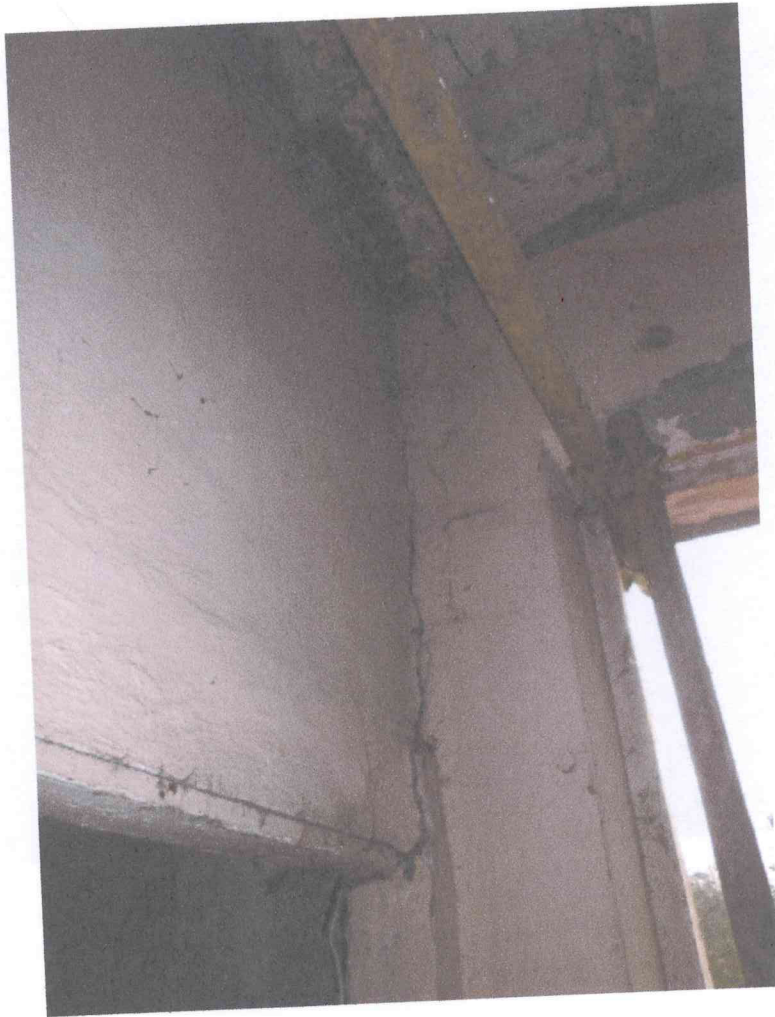
Foto n. 17 Distacchi della fascia di muratura in corrispondenza dell'architrave in mattoni che soggetto a flessione, indotta dal sisma, si è rotto nella zona delle fibre tese e sconnessione delle murature con cinematismo verso l'eterno della parete portante
