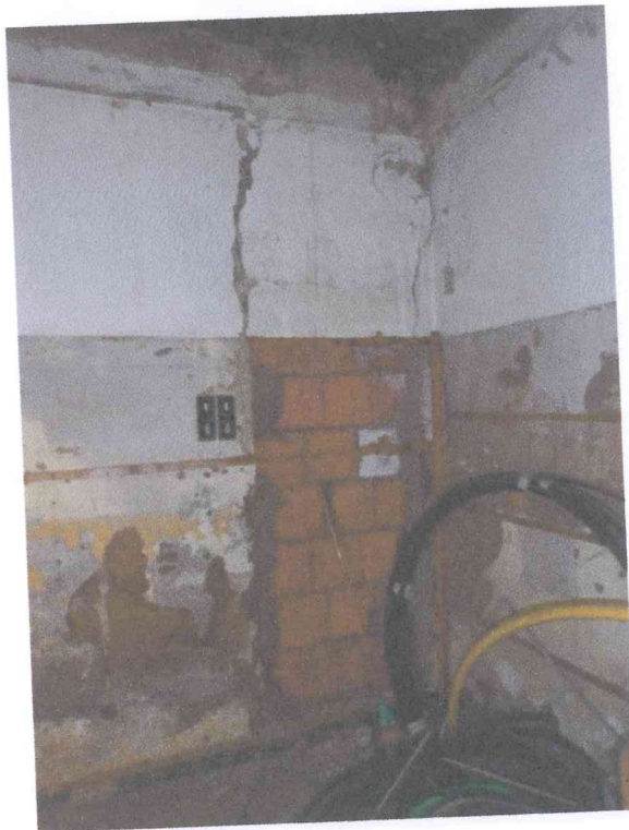
Foto n. 11 Distacchi della fascia di muratura in corrispondenza dell'architrave in mattoni che soggetto a flessione, indotta dal sisma, si è rotto nella zona delle fibre tese e sconnessione delle murature
