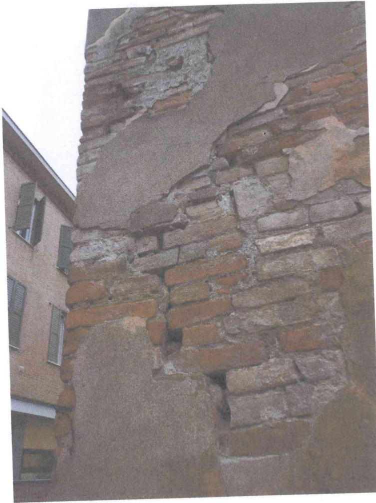
Foto n. 4 Formazione di cuneo dislocato verso l'esterno- si notano molto bene la scarsa qualità della tessitura muraria e le crepe passanti
