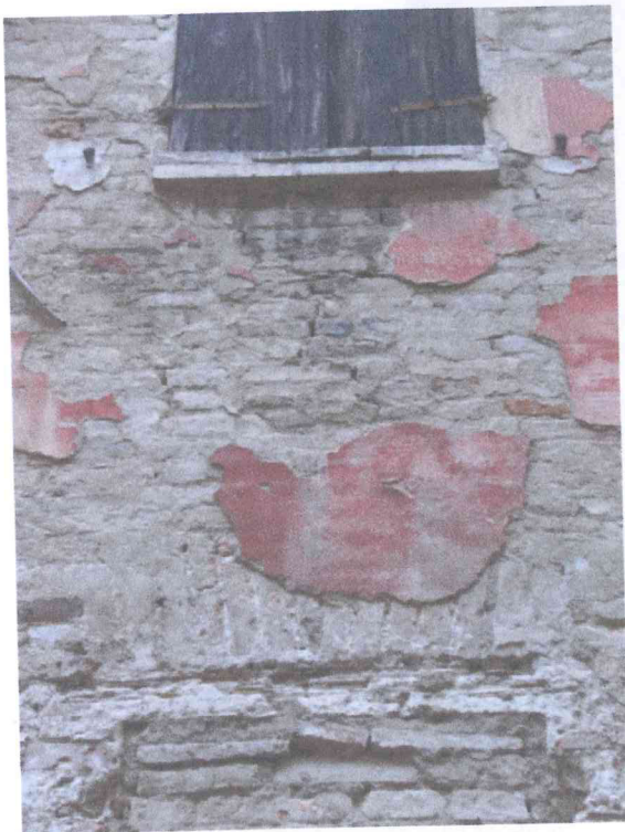
Foto n. 6 Particolare delle crepe a 45°
