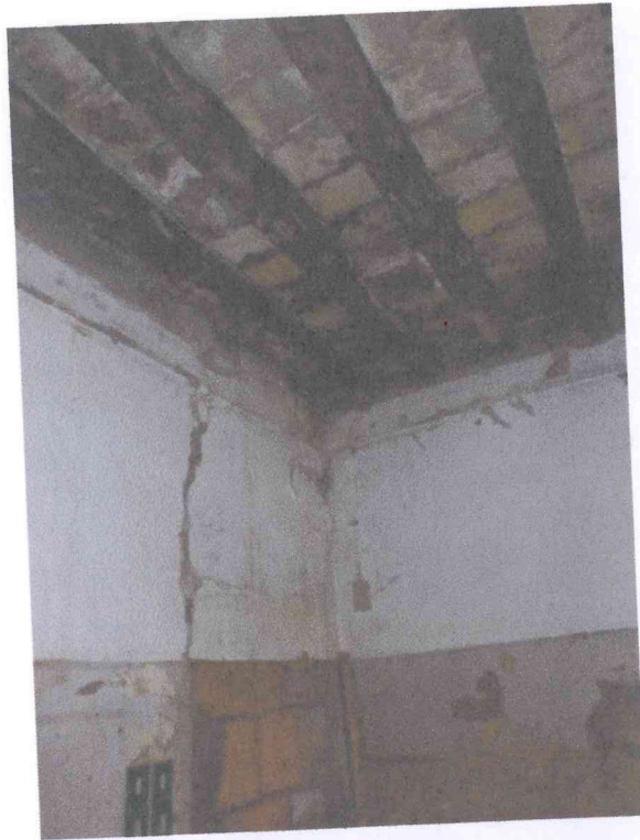
Foto n. 12 Vista solaio in legno ordito senza trave principale con elevata inflessione di piano
