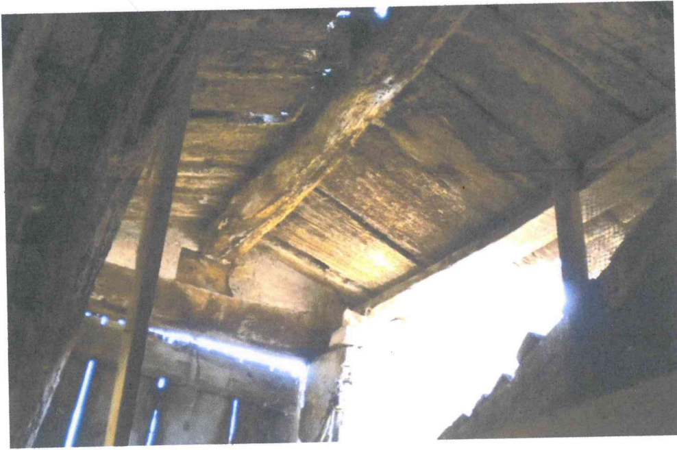
Foto n. 20 Vista dell'abbaino semicrollata e fatiscente
