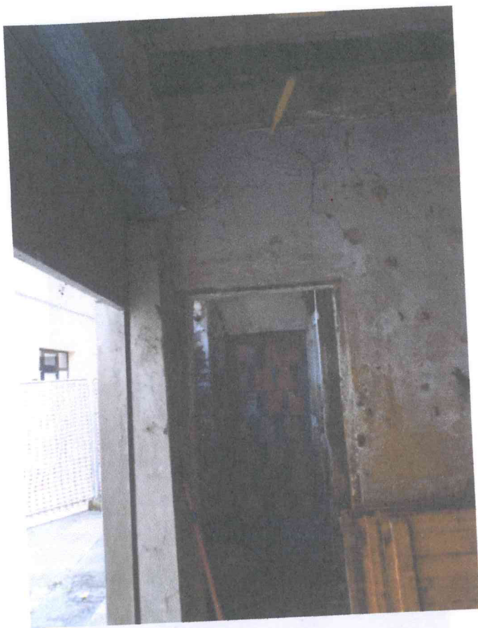
Foto n. 8 Distacchi della fascia di muratura in corrispondenza dell'architrave in mattoni che soggetto a flessione, indotta dal sisma, si è rotto nella zona delle fibre tese e sconnessione delle murature
