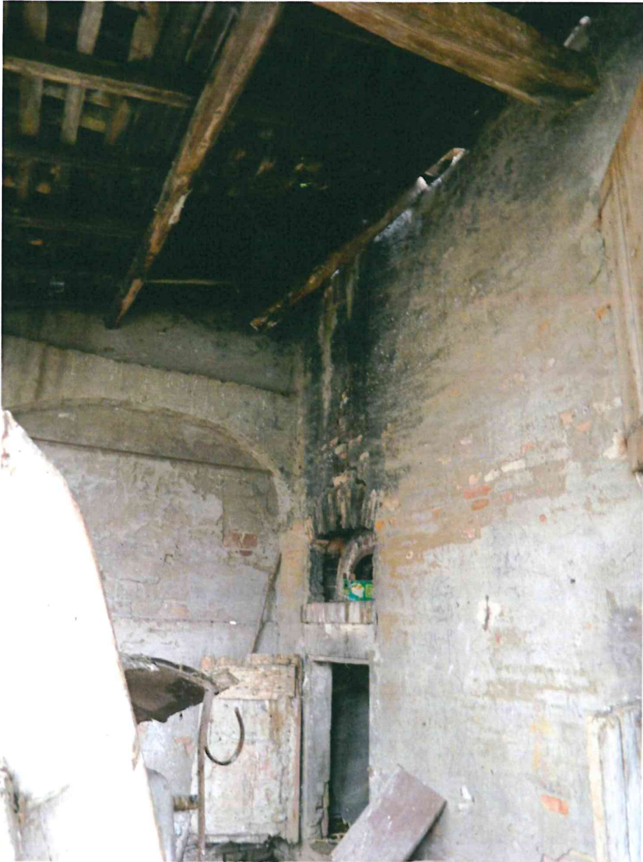
Copertura ed attacco alle pareti in muratura inesistente
