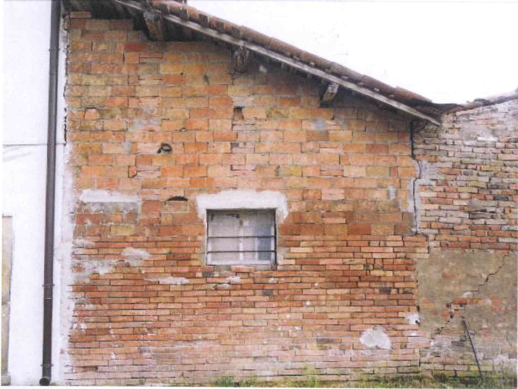
Cattiva tessitura muraria, lesioni passanti, carenza di buone connessioni tra struttura orizzontale e murature portanti
