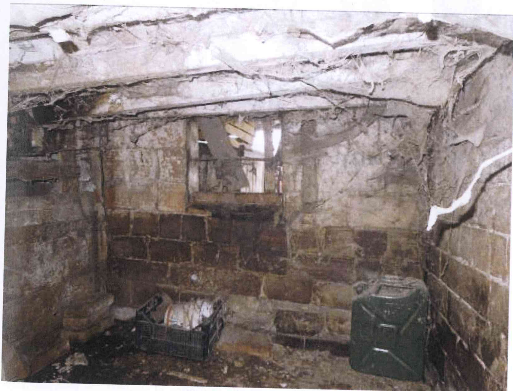
Stato manutentivo scarso, umidità di risalita
