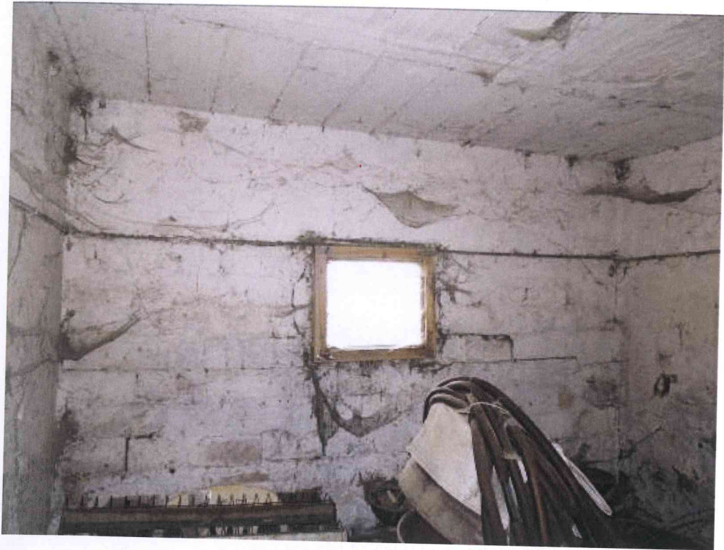
Stato manutentivo scarso, umidità di risalita
