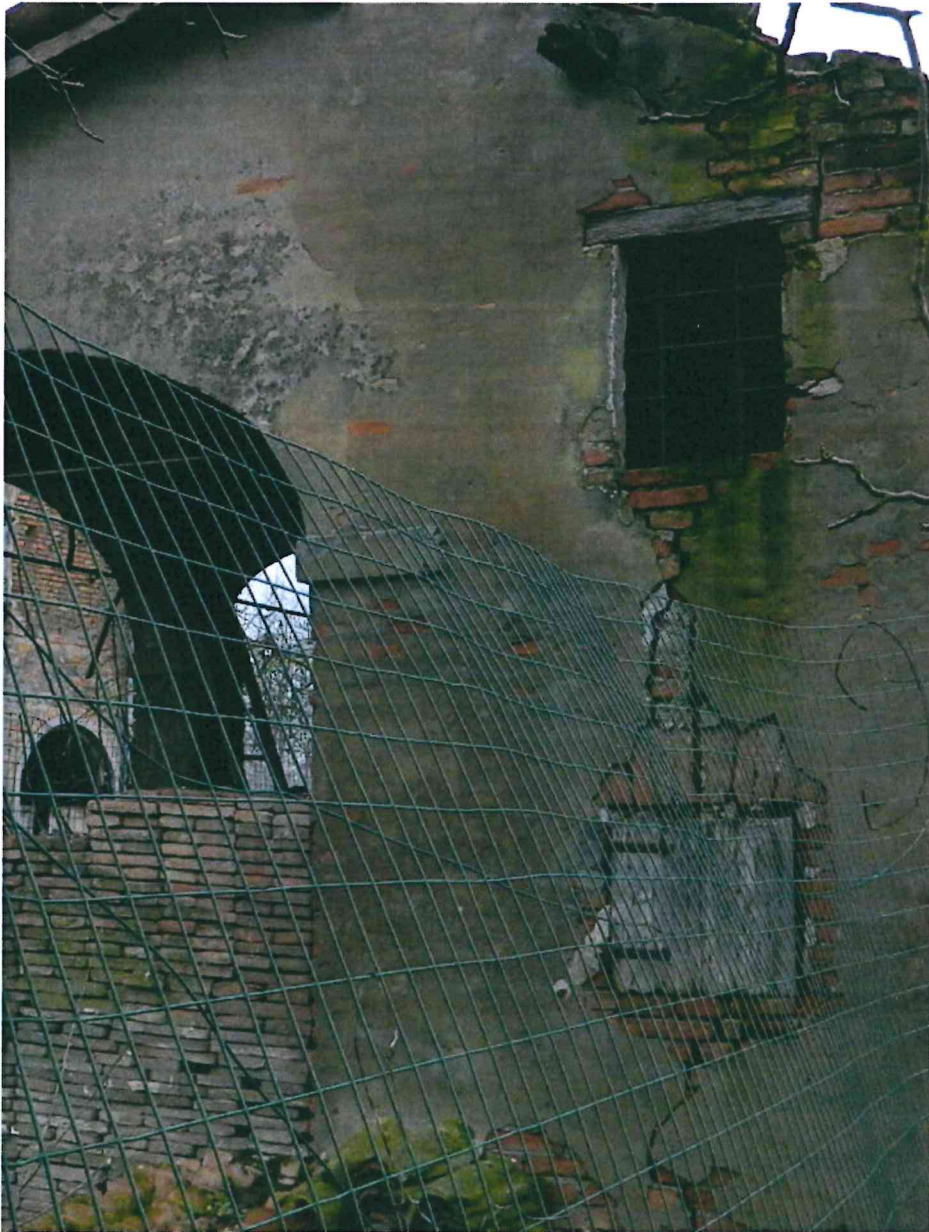
Particolare della lesione sulla parete laterale e del crollo della copertura
