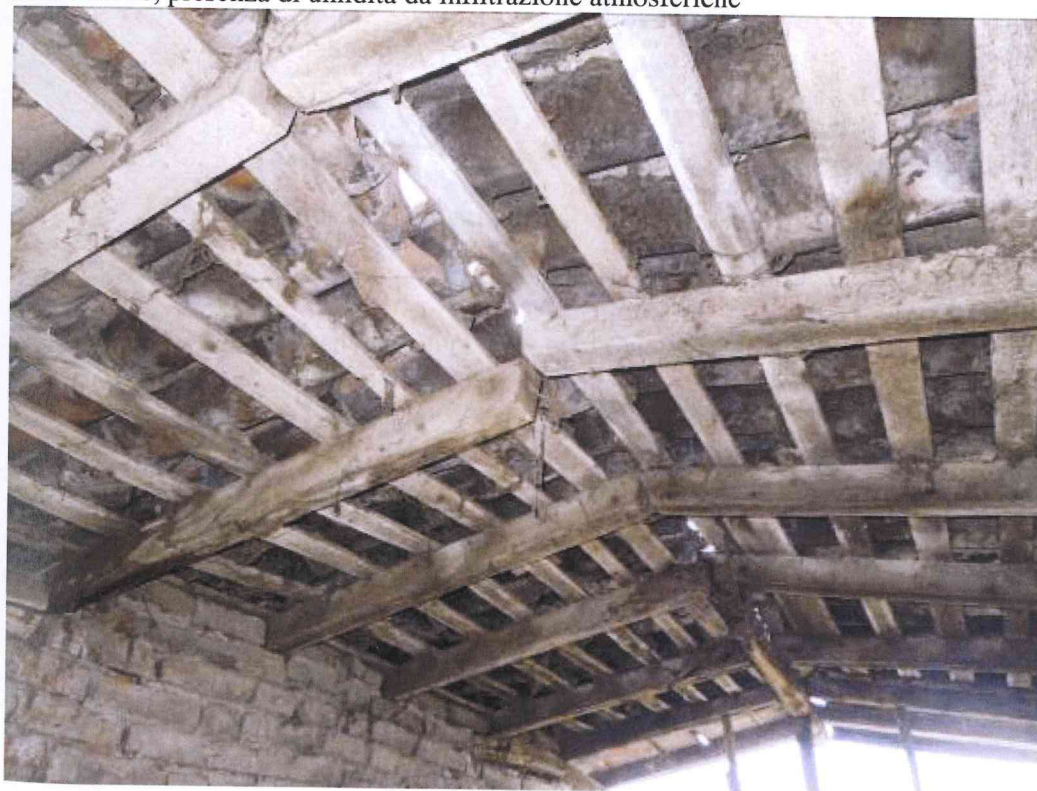
Mancanza di tavolato per la copertura che ha causato marcescenze e cedimenti di piano deformabile, presenza di umidità da infiltrazione atmosferiche, elementi in legno, sia nei solai che nel tetto, di dimensioni e stato conservativo fra i più svariati ed inaffidabili
