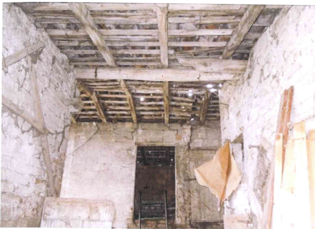
Mancanza di tavolato per la copertura che ha causato marcescenze e cedimenti di piano deformabile, presenza di umidità da infiltrazione atmosferiche
