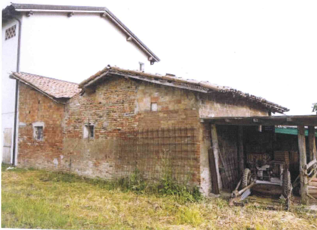
Cattiva tessitura muraria, lesioni passanti
