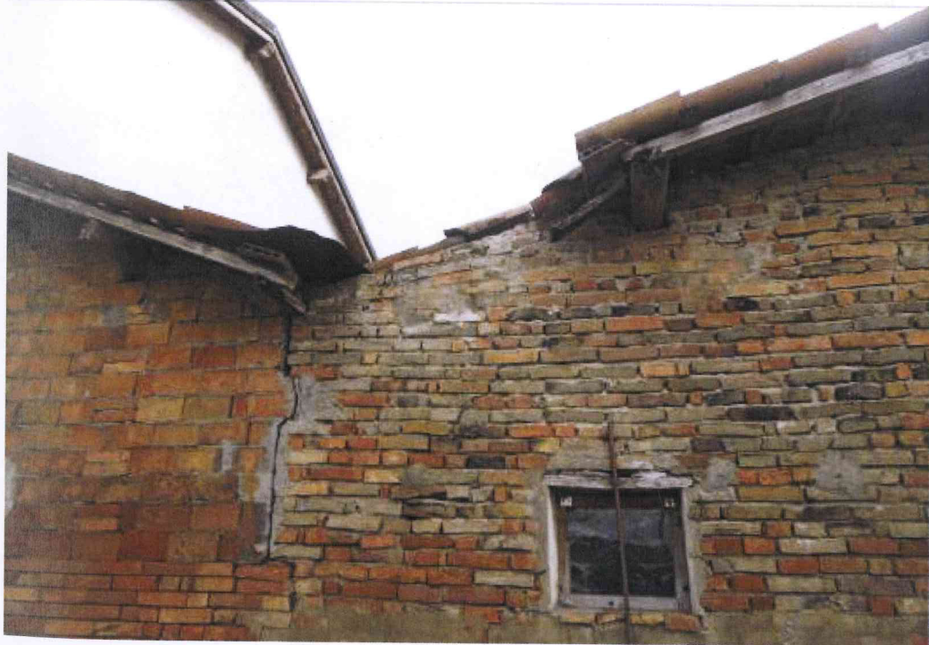
Cattiva tessitura muraria, lesioni passanti e cedimenti, mancanza di connessioni tra paramenti murari, carenza di buone connessioni tra struttura orizzontale e murature portanti, scorrimento dei coppi e cedimenti diffusi delle strutture di tutta la copertura
