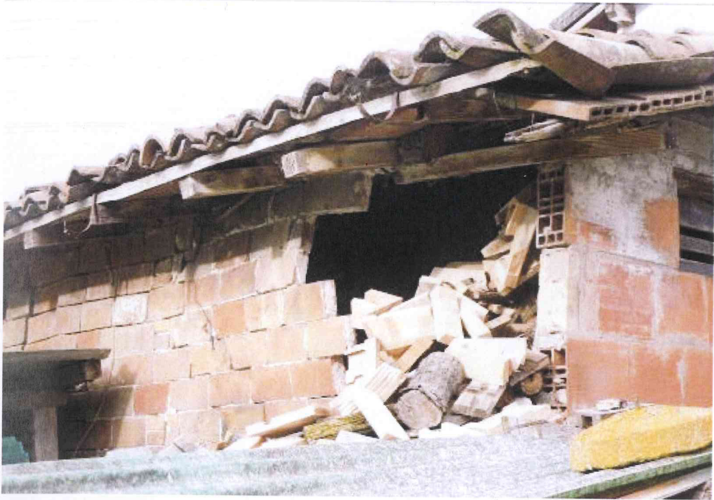
Cattiva tessitura muraria, lesioni passanti e cedimenti, mancanza di connessioni tra paramenti murari, carenza di buone connessioni tra struttura orizzontale e murature portanti, scorrimento dei coppi e cedimenti diffusi delle strutture di tutta la copertura
