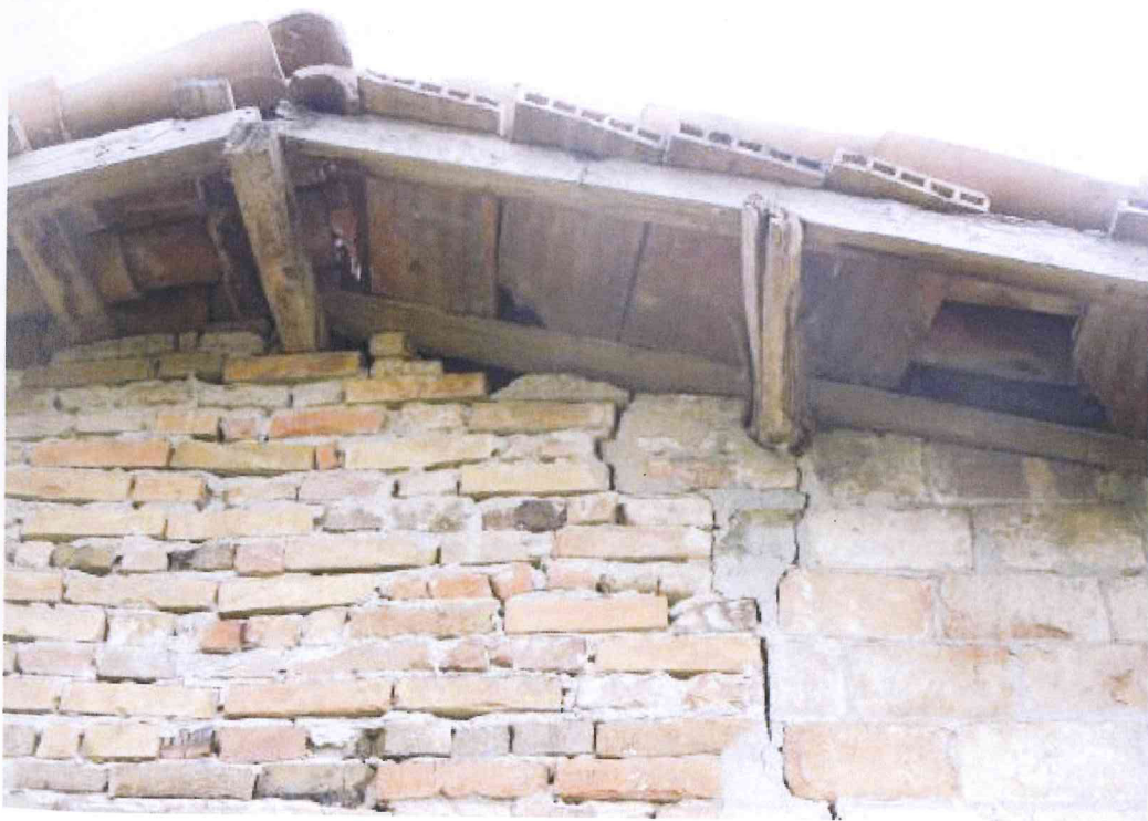
Carenza di buone connessioni tra struttura orizzontale e murature portanti
