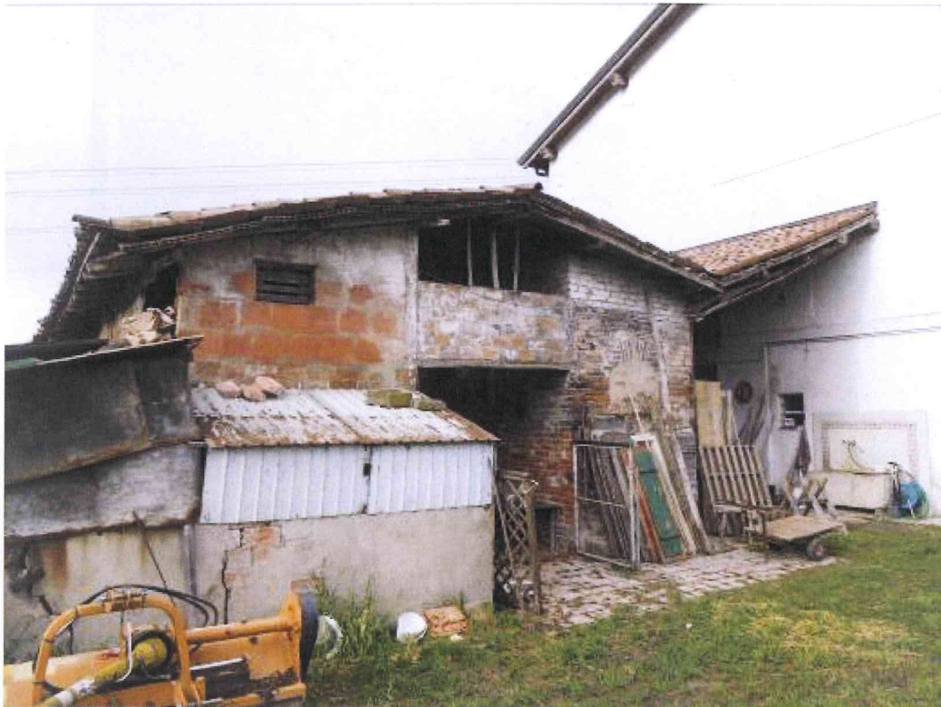
Cattiva tessitura muraria
